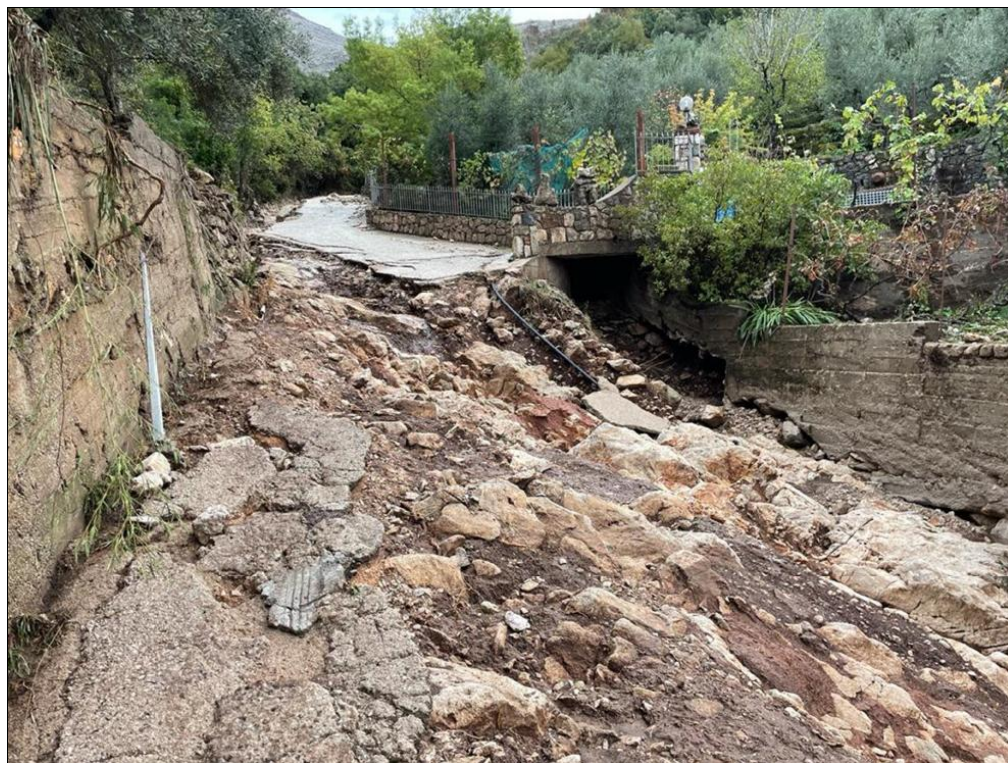
Foto 9 – Sede stradale completamente divelta dalla fuoriuscita di acqua e detriti in corrispondenza di un tombinamento e relativo restringimento della sezione di scorrimento del fossato in località Campiglioni.
