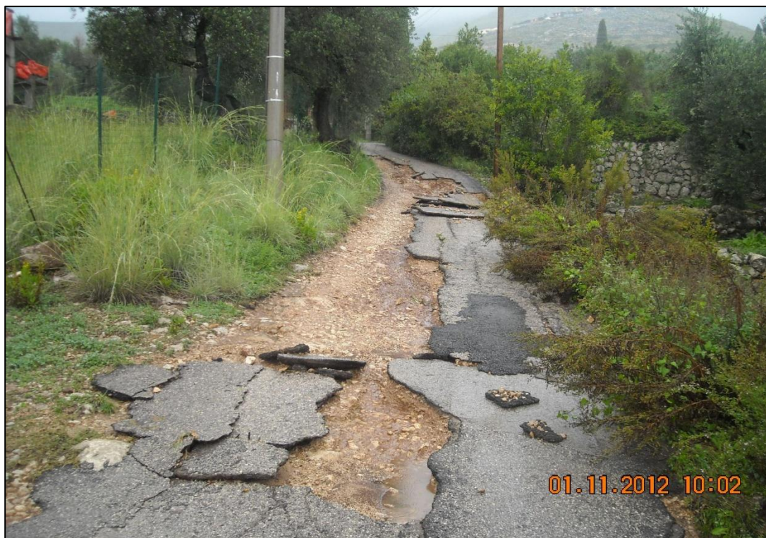
Foto 7 – Sfaldamento manto stradale a seguito di abbondanti precipitazioni.
