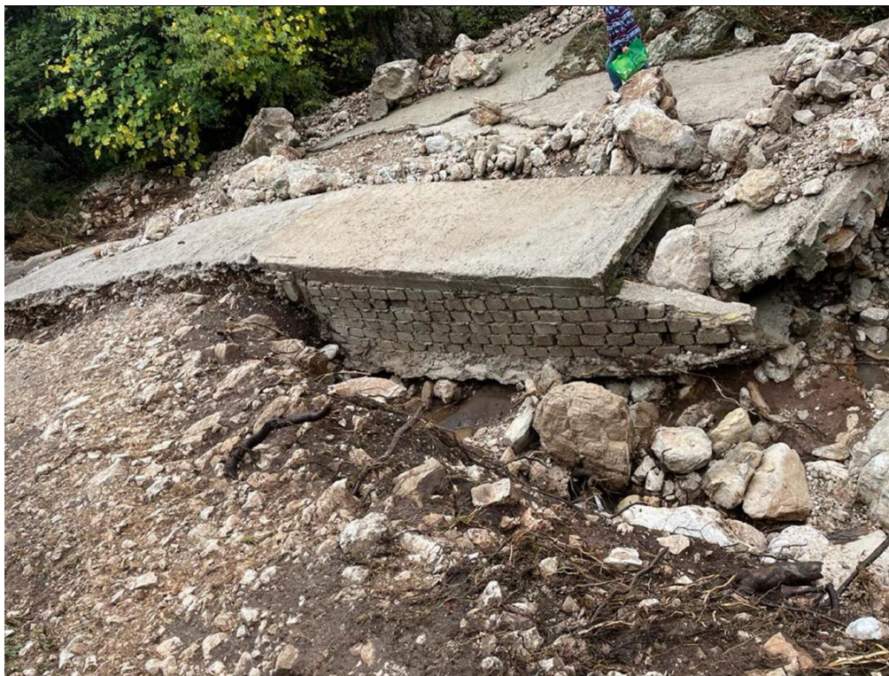
Foto 10 – Sede stradale completamente divelta dalla fuoriuscita di acqua e detriti in corrispondenza di un restringimento della sezione di scorrimento del fossato.
