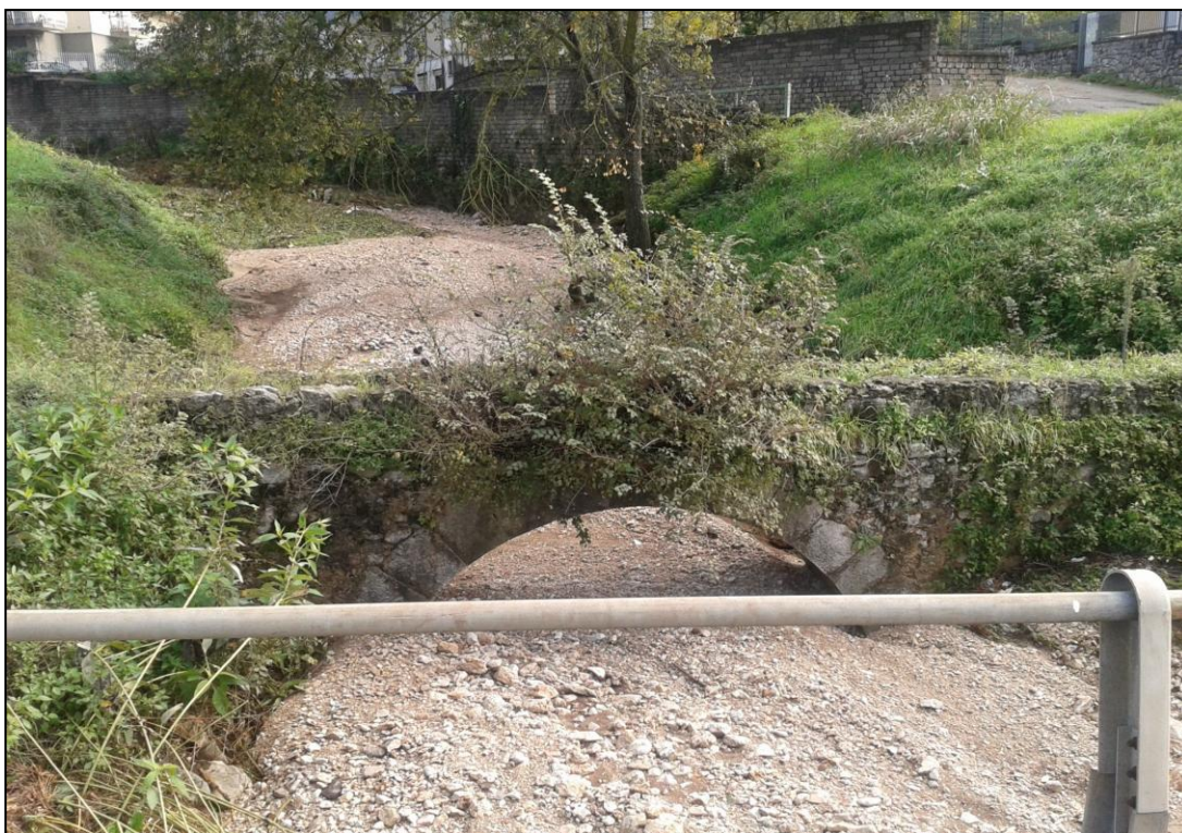
Foto 3 – Detriti accumulati all'interno del Fosso di Valle.
