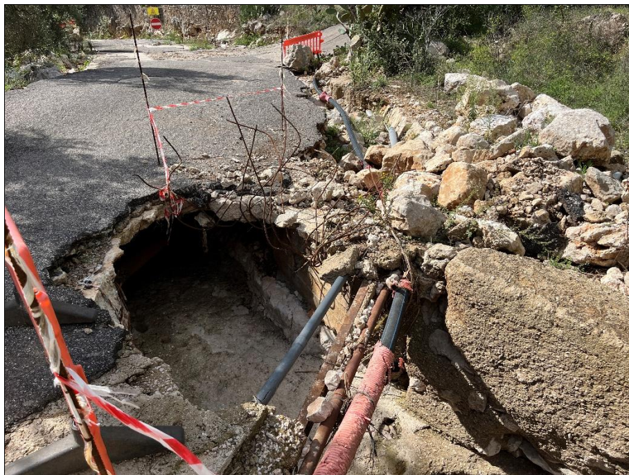
Foto 24 – Distruzione della sede stradale con interessamento dei servizi a rete in località Campiglioni.
