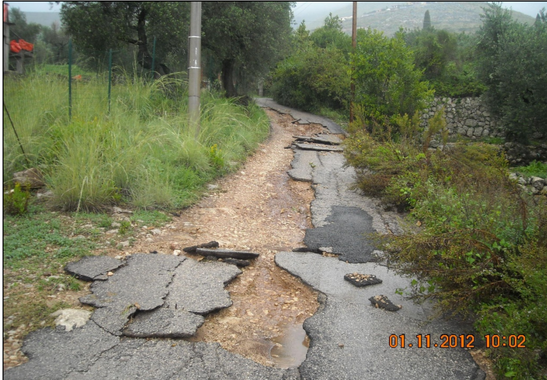
Foto 7 – Sfaldamento manto stradale
