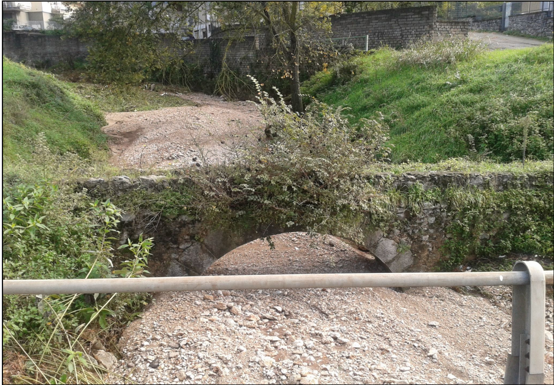
Foto 3 – Colata detritica all'interno del Fosso di Valle
